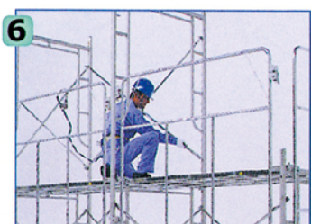
6 2層目の建わくを組み立て、躯体側の足場に交さ筋かいを設置します。
